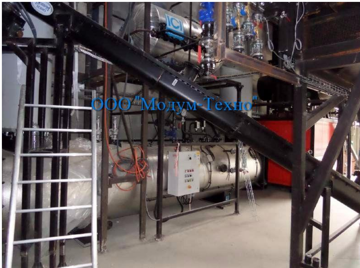
Котел-утилизатор с деаэратором
